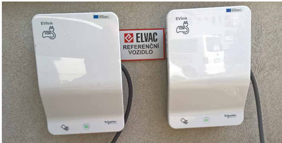
Obr. 2 Parkoviště s nabíjecími stanicemi pro elektromobily firmy ELVAC
